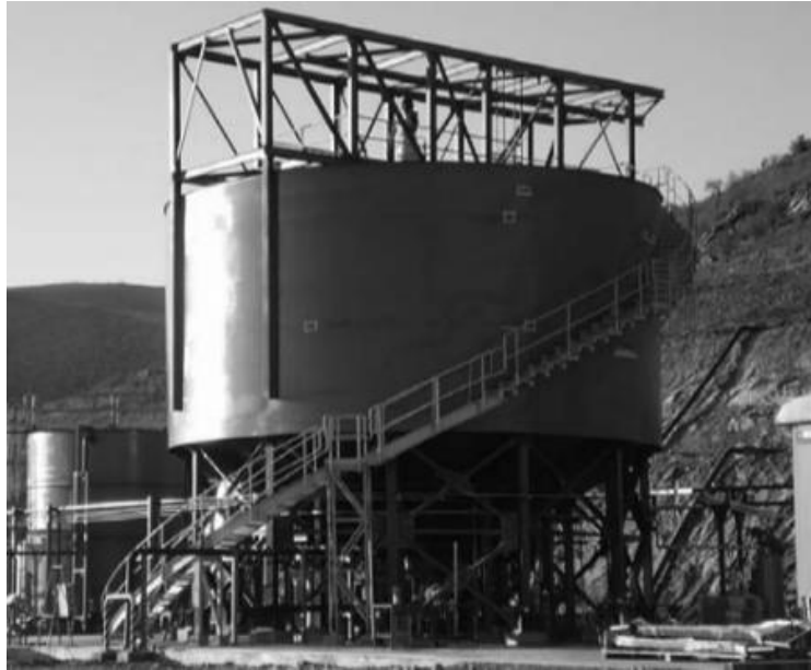
Figura 2.2. Sedimentador de Alta densidad. (Schoenbrunn, 2011)
